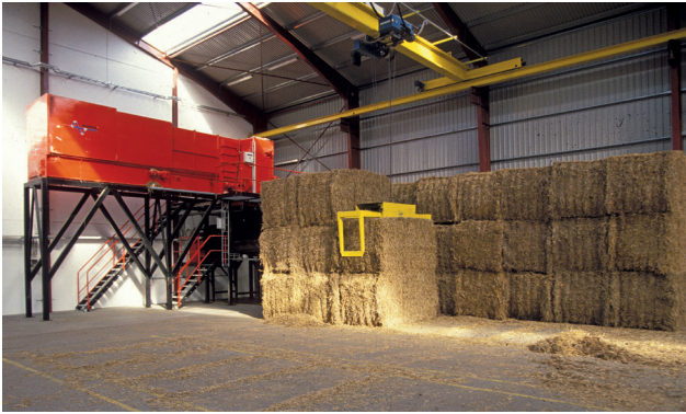
Almacén de paja en la planta de calefacción urbana de Terndrup. El transporte desde el almacén hasta la caldera se realiza con una grúa controlada automáticamente. El almacén puede contener paja durante aproximadamente una semana de funcionamiento durante el invierno.
