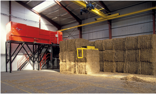
Réserve de paille à l'usine de chauffage du district de Tørndrup. La grue est contrôlée automatiquement et coulisse vers le foyer. La réserve peut contenir l'équivalent d'une semaine d'exploitation pendant l'hiver. PHOTO Torben Skøtt, BioPress.
