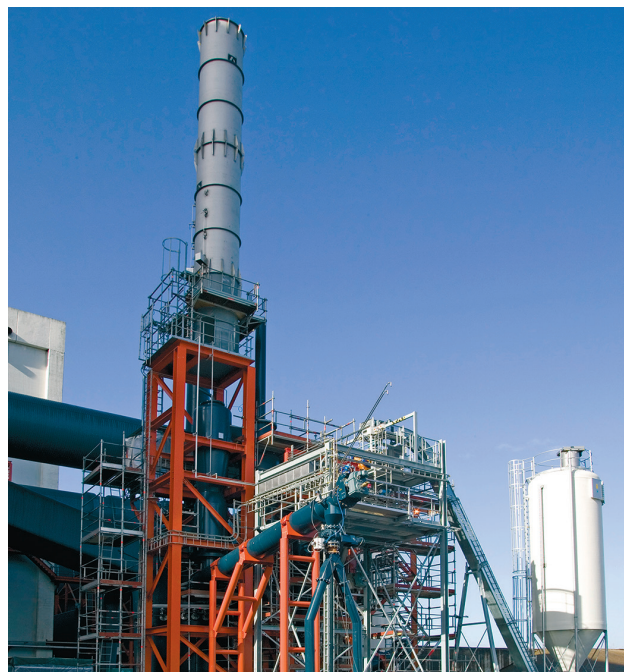
L'usine de gazéification Pyroneer à Kalundborg.
