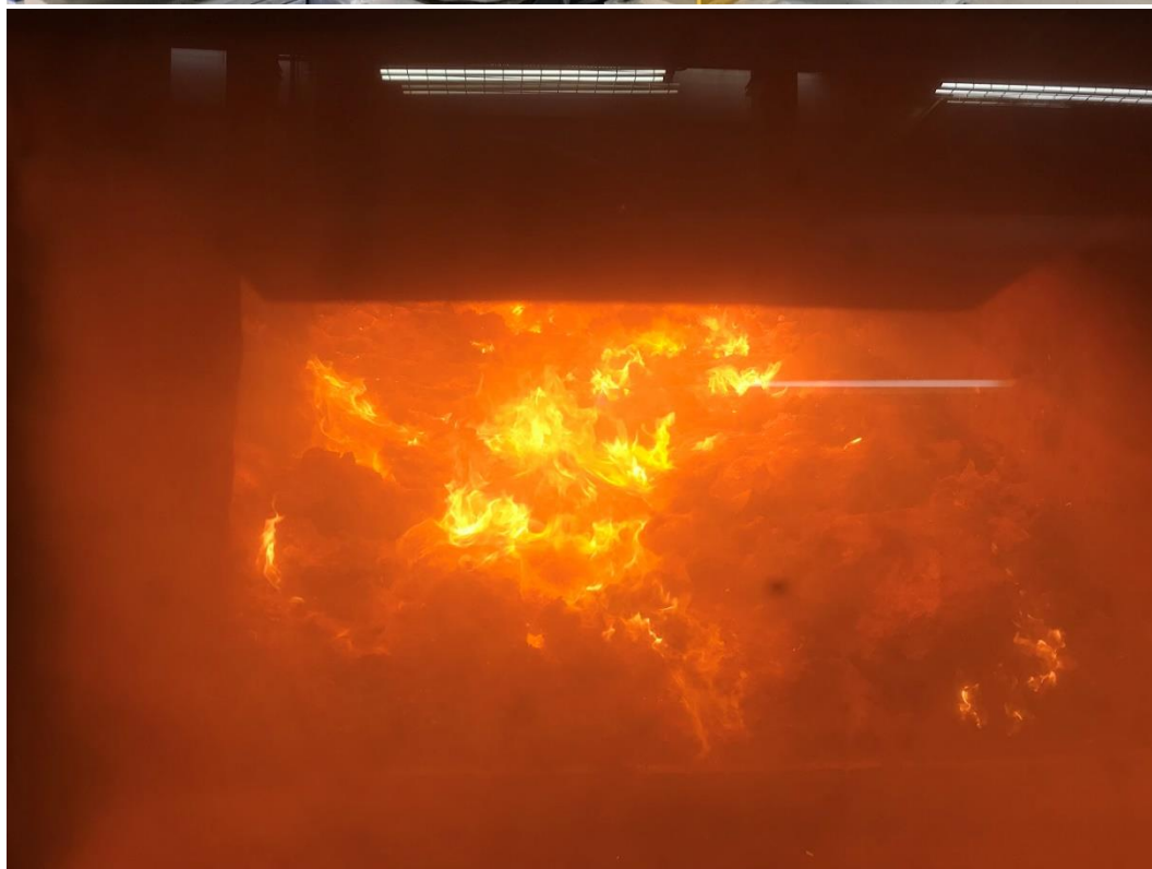
Ristefyret kedel samt kig ind i kedlen under forbrændingen.
