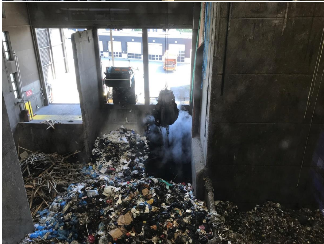
Kontrolrum til styring af grab samt opgrabning af blanding af gyllefiber og hønsemøg. Begge biomasser blev læsset af i den ene side af siloen og blev blandet med grabben.
